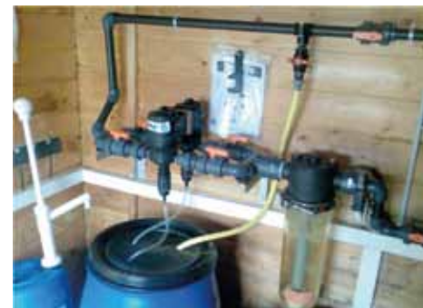
Impianto miscelazione prodotti chimici Chemical products mix system
