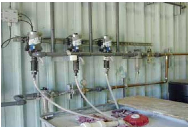
Impianto multiplo di miscelazione Multiple mix system
